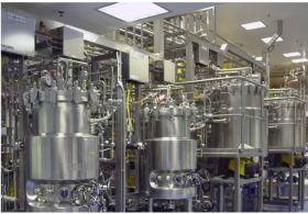
Pharmaceutical Plant Project 制药厂项目
